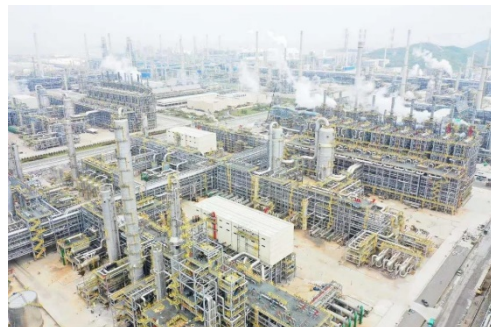
浙江石化2#乙烯项目
